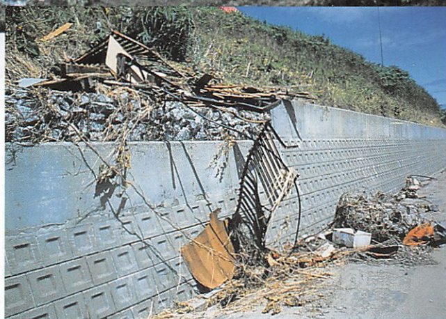
図3 津波による被害の一部
